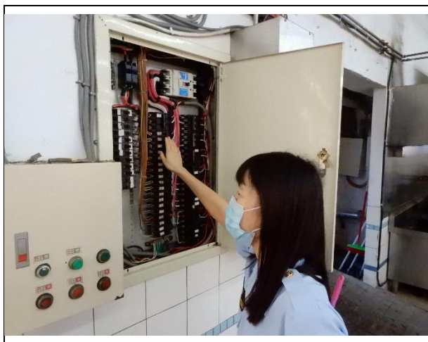
緊急防護訓練(關閉電源)
