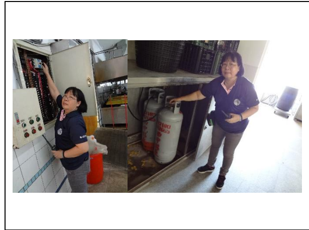
炊場火災，關閉火源電源(安全防護)
