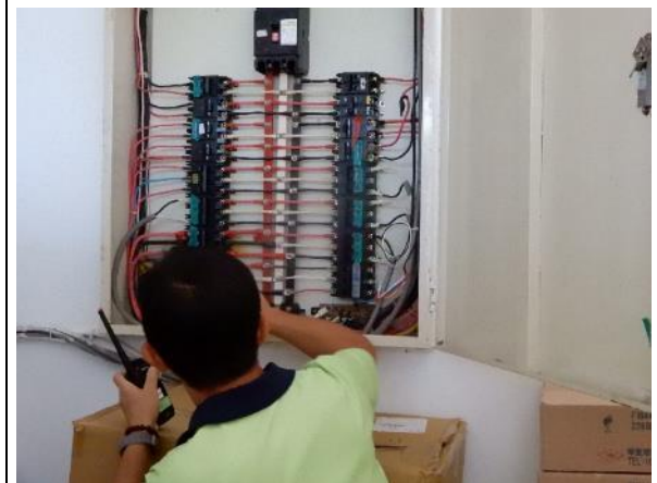
營繕隊主管前往關閉技訓區電源
