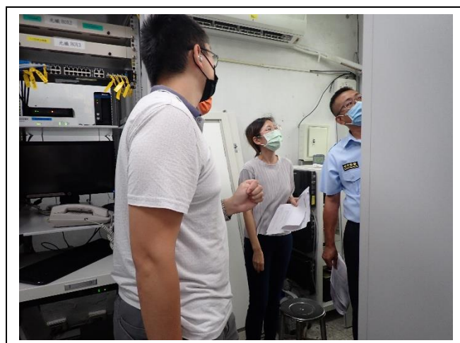
於機房確認電腦主機規格
