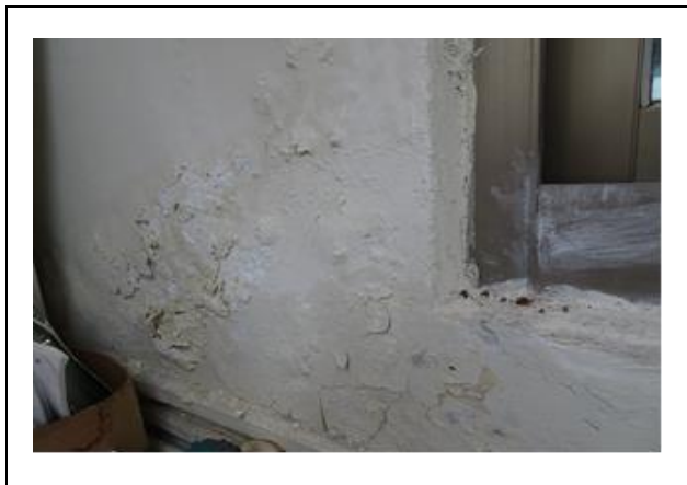
診間壁癌剝落情形
