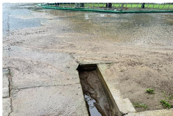
排水溝牆面坍方造成水溝淤積
